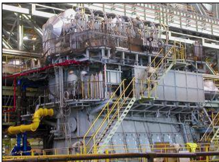
Rys. 1 Widok wolnoobrotowego wysokoprężnego okrętowego silnika głównego Fig. 1 View of main marine low speed diesel engine
